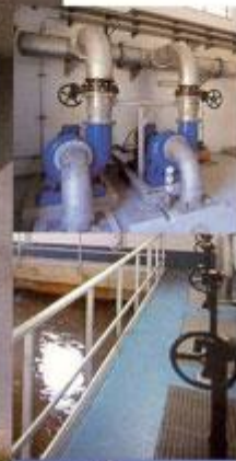
Salle des pompes
